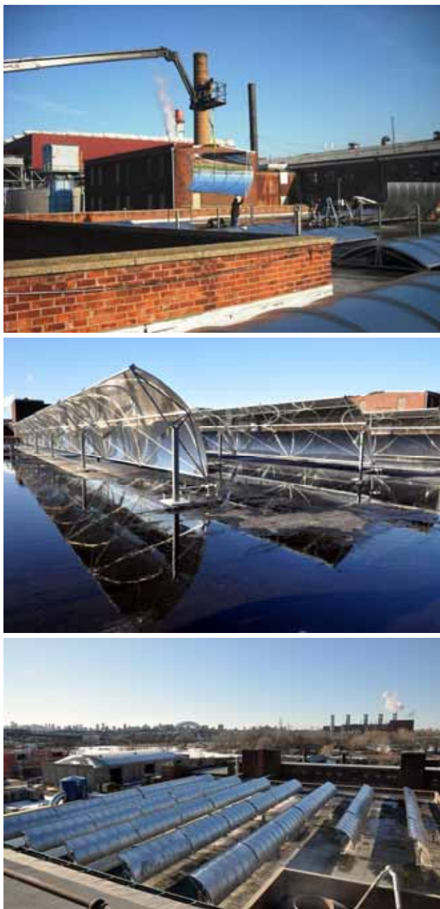
Figure 2: Abengoa IST Parabolic Solar Collectors (stowed position)
